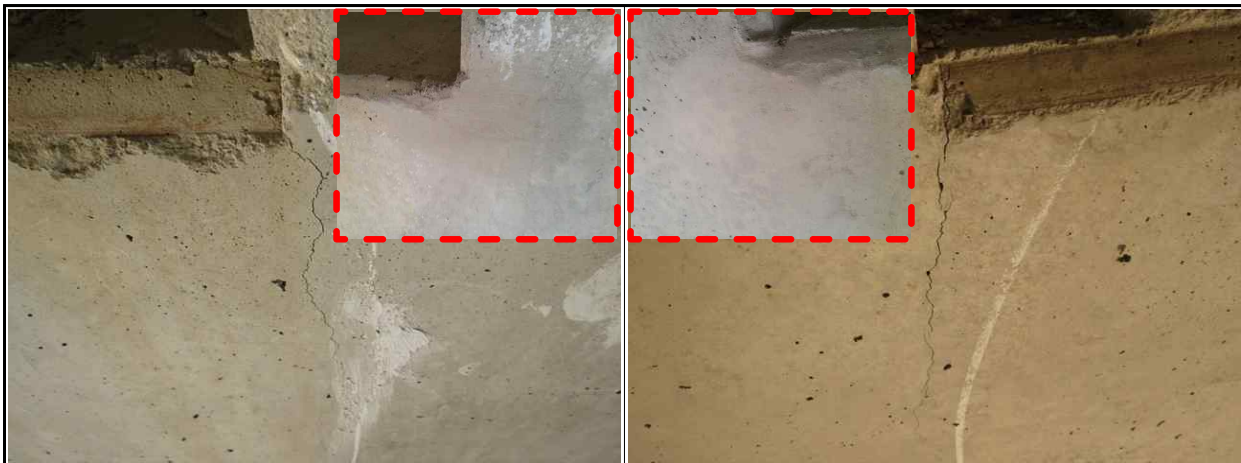
교각 P1(옥산방향) 균열(폭 0.2mm)(보수완료)
